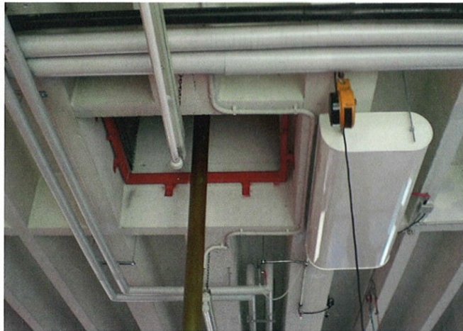
Die kombinierte Düsen-Ventilator-technik trennt im Brandfall wie eine unsichtbare Wand Rauch vom rauchfreien Bereich. Werkbild
