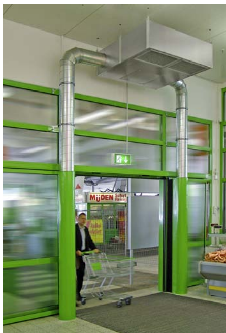
Attraktiv gestaltete Luftwandanlage an einem Marktzugang.
